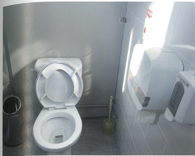
衛生器具竣工照片
