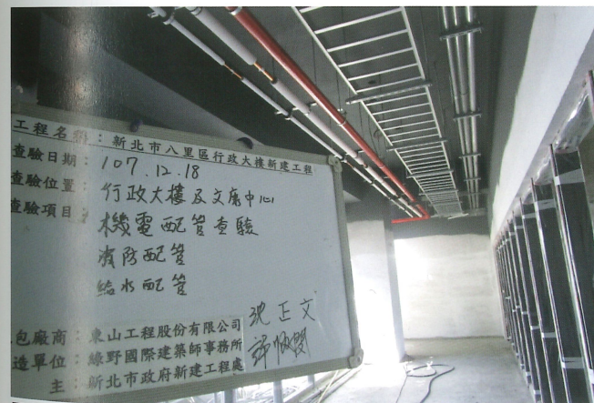
天花板上各種管線明管照片
