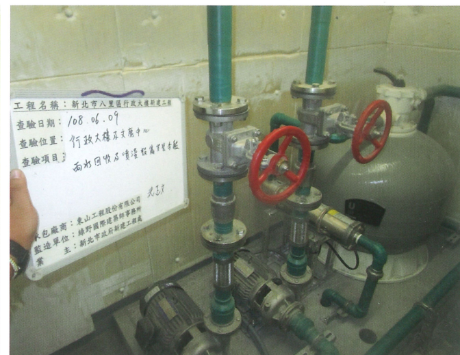
雨水回收設備竣工照片
