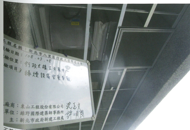
天花板上各種管線明管照片
